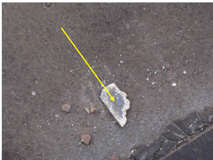
foto: Restanten asbesthoudend materiaal
