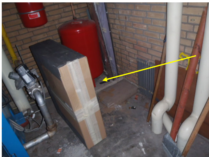
foto: Stof, duidelijk asbest aantoonbaar
