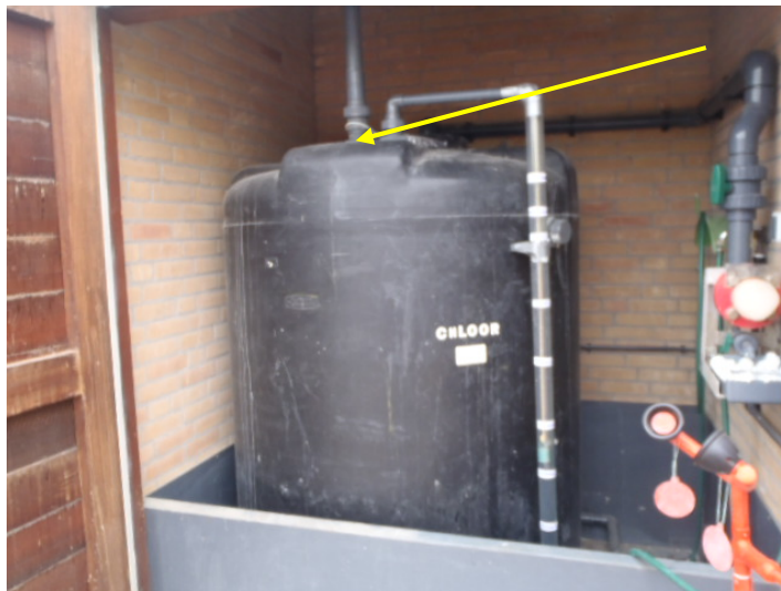
foto: Stof, duidelijk asbest aantoonbaar
