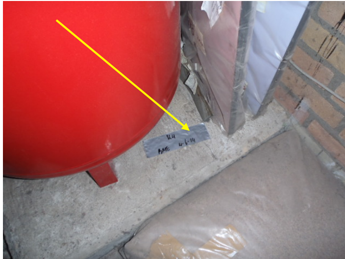
foto: Stof, geen asbest aantoonbaar - K2 - K4
