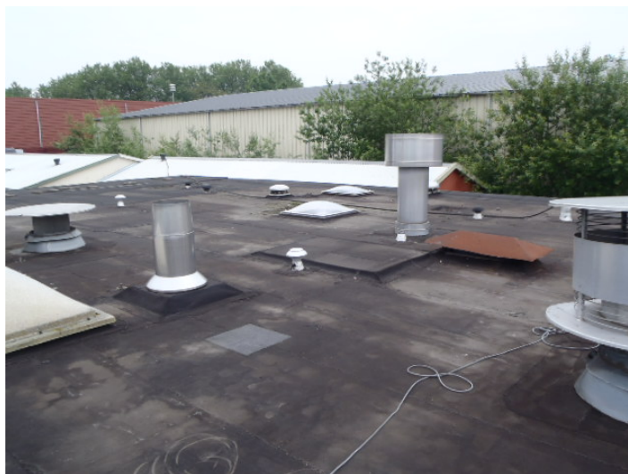
foto: Restanten asbesthoudend materiaal
