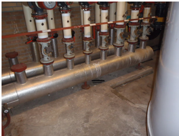
foto: Stof, duidelijk asbest aantoonbaar
