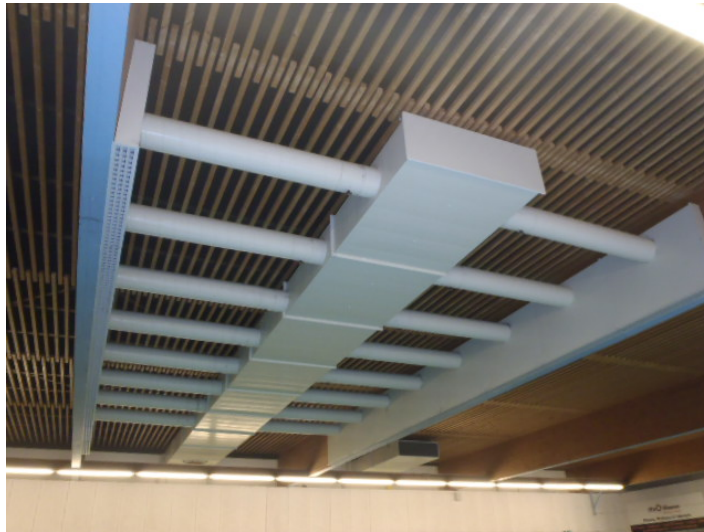
foto: Ventilatiekanaal - M8
