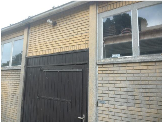
Foto 7. Asbesthoudende dilatatiekit (bron Bron2)
