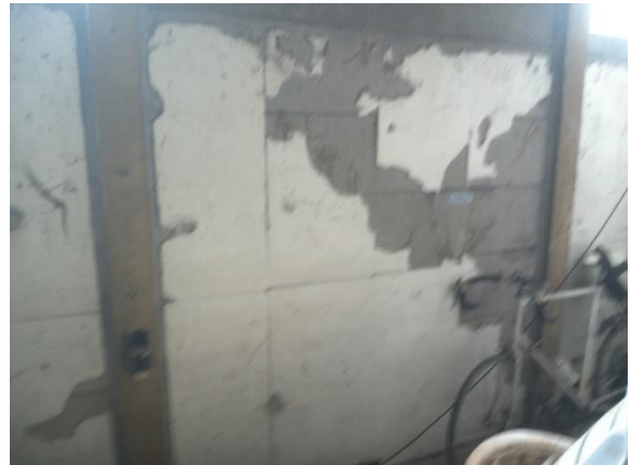
Foto 16. Asbesthoudende dilatatiekit (bron Bron3)
