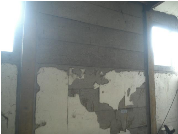
Foto 15. Asbesthoudende dilatatiekit (bron Bron3)
