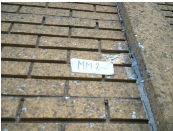
Foto 11. Asbesthoudende dilatatiekit (bron Bron2)
