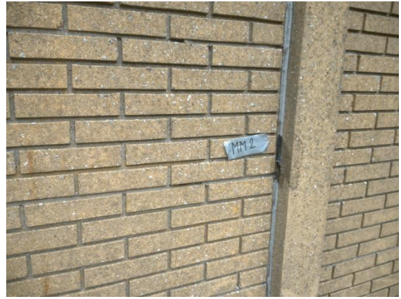
Foto 8. Asbesthoudende dilatatiekit (bron Bron2)
