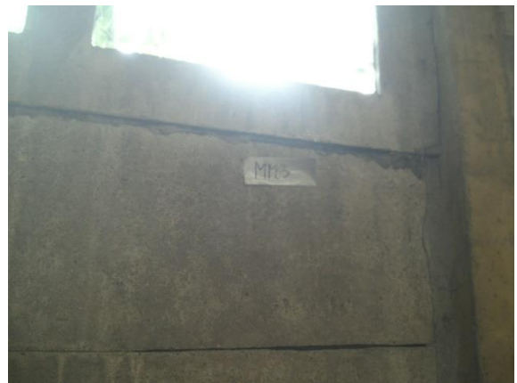
Foto 18. Asbesthoudende dilatatiekit (bron Bron3)
