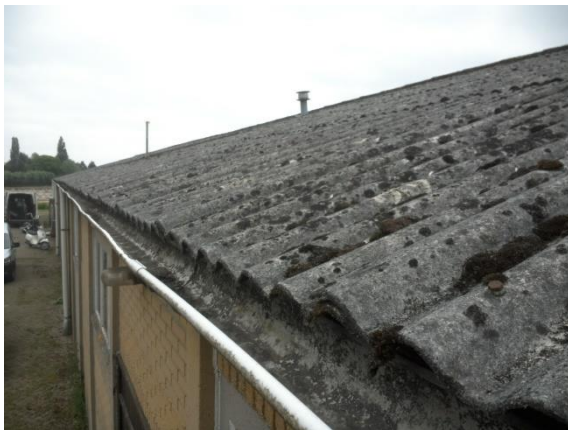
Foto 3. Asbesthoudende golfplaat inclusief hulpstukken (bron Bron1)
