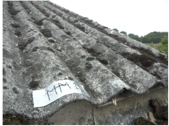
Foto 2. Asbesthoudende golfplaat inclusief hulpstukken (bron Bron1)
