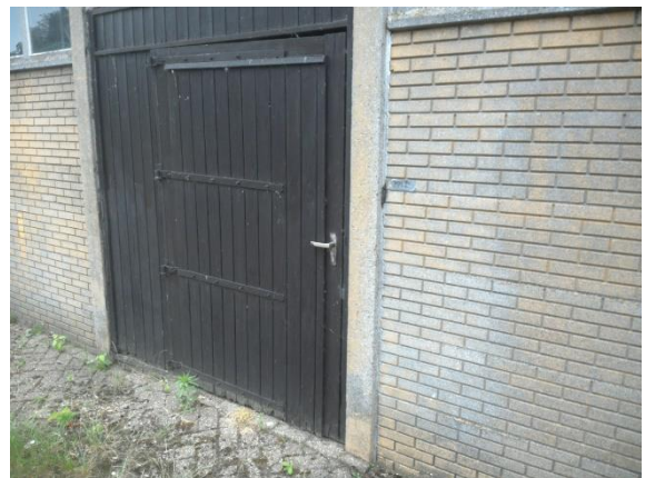
Foto 6. Asbesthoudende dilatatiekit (bron Bron2)
