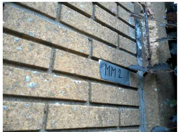
Foto 12. Asbesthoudende dilatatiekit (bron Bron2)
