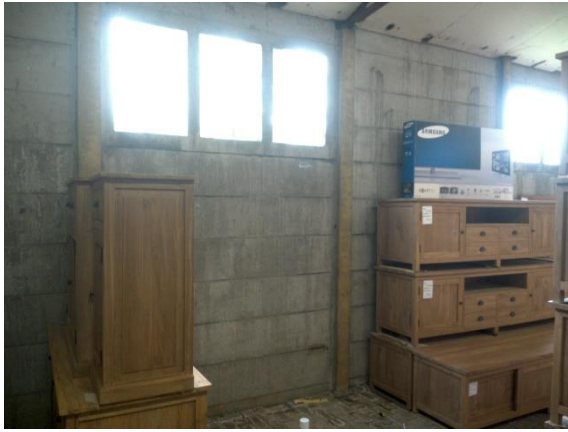
Foto 19. Asbesthoudende dilatatiekit (bron Bron3)
