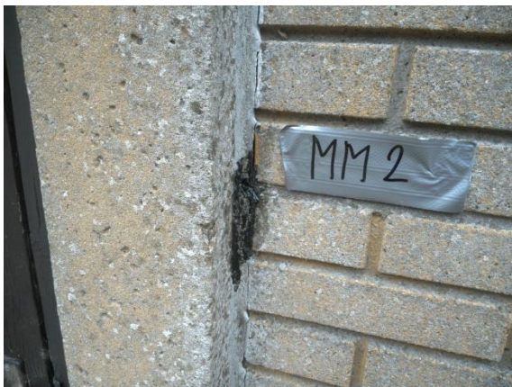
Foto 5. Asbesthoudende dilatatiekit (bron Bron2)
