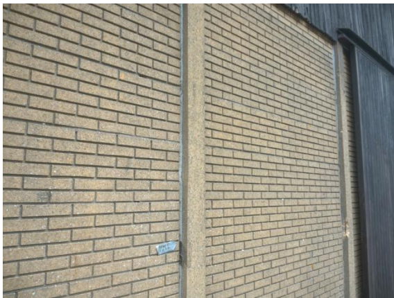
Foto 9. Asbesthoudende dilatatiekit (bron Bron2)
