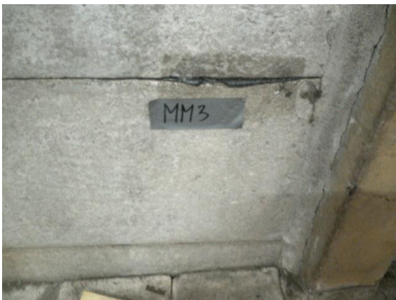
Foto 17. Asbesthoudende dilatatiekit (bron Bron3)
