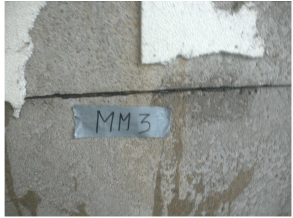
Foto 14. Asbesthoudende dilatatiekit (bron Bron3)
