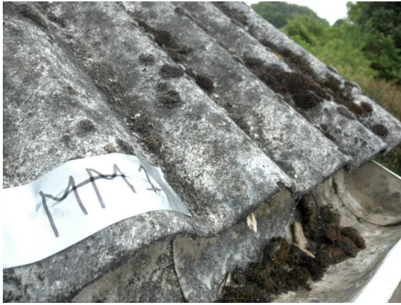
Foto 1. Asbesthoudende golfplaat inclusief hulpstukken (bron Bron1)
