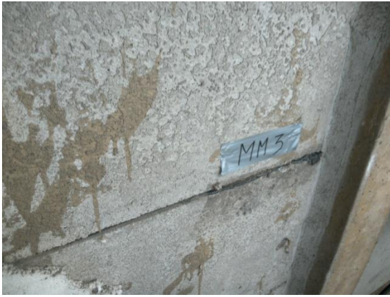
Foto 13. Asbesthoudende dilatatiekit (bron Bron3)
