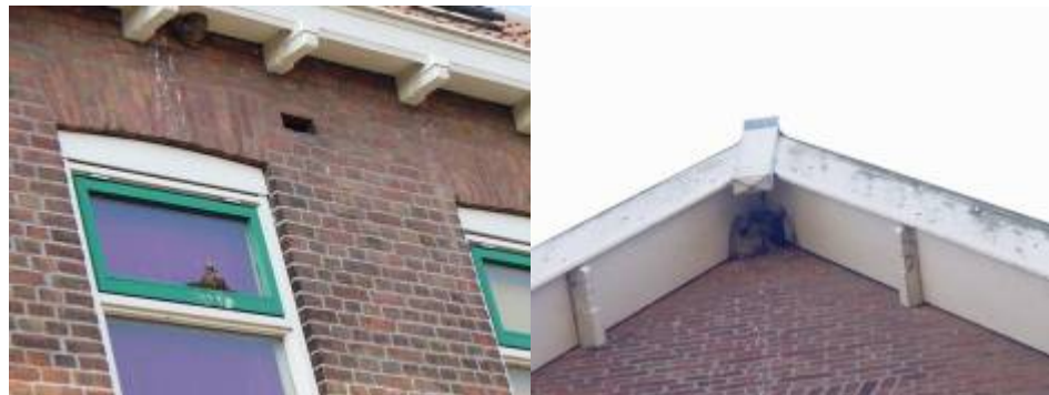
Foto 3- 4: dakrand met nest- verblijfplaats huiszwaluw.
