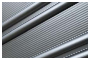
Bepaling, qua profiel en textuur afgestemd op de omvang van het gebouwonderdeel
