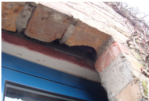
Afbeelding 3; gat naar spouwmuur
