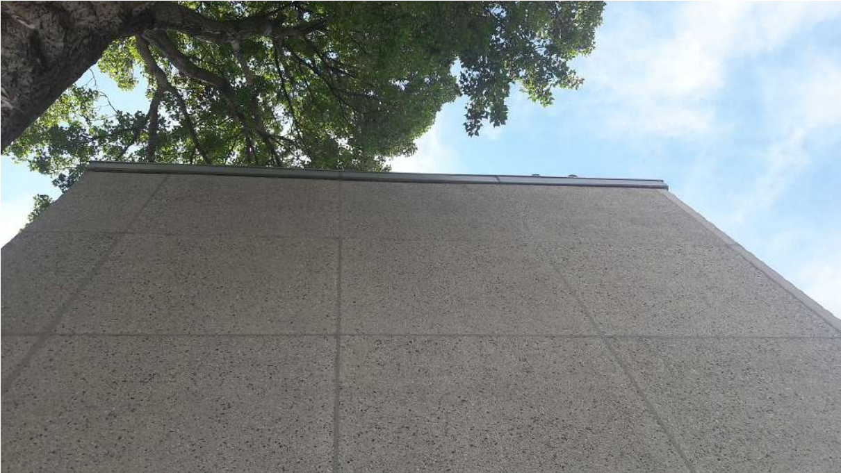
Gevel aan de oostzijde van het plangebied met ruimte tussen metalen strip en boeiboord.
