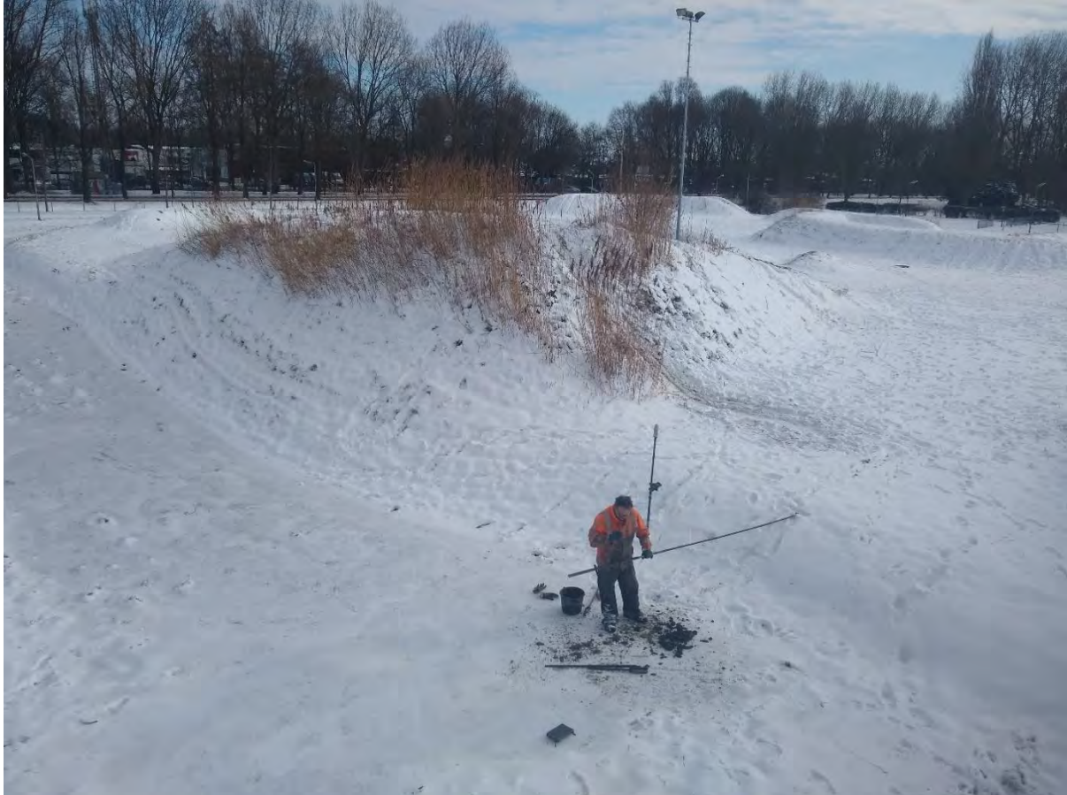
Figuur 2. Situatiefoto tijdens de uitvoering van boring 25. De foto is richting het oosten genomen. In de achtergrond is de ophoging ter plaatse van de crossbaan zichtbaar.
