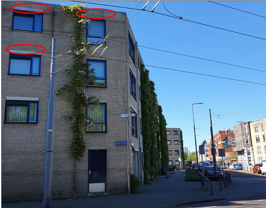
Figuur: in het gebouw op de hoek van de Crooswijkseweg en de Pijperstraat is een kraamkolonie aangetroffen met circa 85 in- en uitvliegers. De vleermuizen gebruikten de open stootvoegen (meestal de bovenste rij) als in- en uitvliegopening. Zowel aan de gevel aan de Pijperstraat als de gevel aan de Crooswijkseweg zijn in- en uitvliegers waargenomen.
