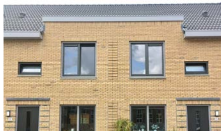
motief 2: Plaatselijke onderbreking gootlijn door opgaand metselwerk
