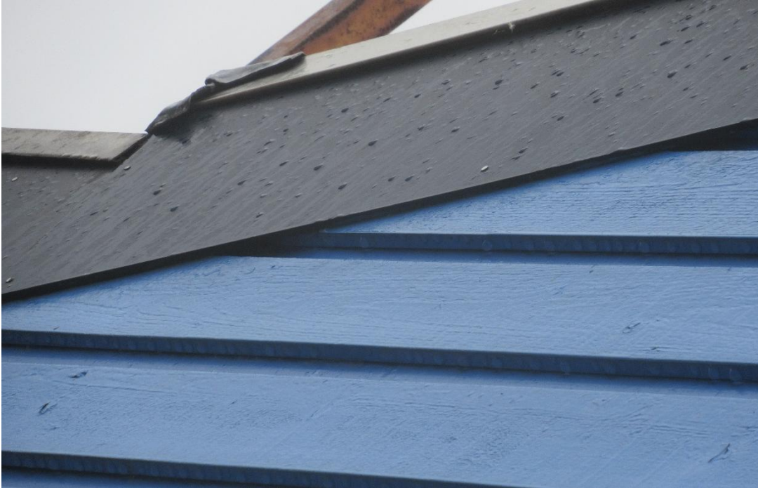
Figuur 3.1: geen ruimte achter geplaatste gevelbetimmering
