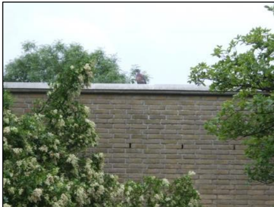
Foto 1: Open stootvoegen in gebouw
