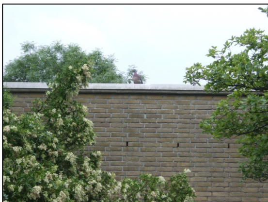
Foto 1: Open stootvoegen in gebouw
