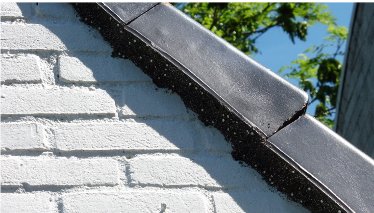
Detail woonhuis: afgedichte dakrand ontoegankelijk voor vogels of vleermuizen
