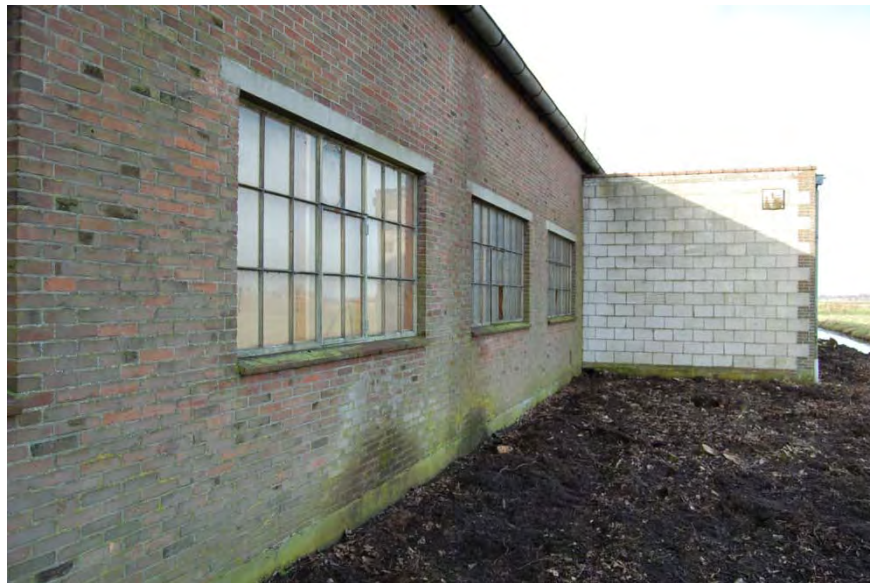
Overzicht van de oostgevel van gebouw I. Rechts op de achtergrond de zuidgevel van gebouw L.
