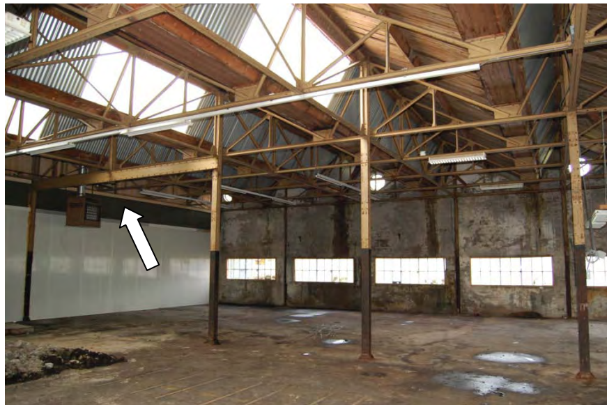
Overzicht van de beuken C en D, gezien naar het oosten. Links op de foto valt te zien dat een van de kolommen ontbreekt, waartoe een hulpconstructie is aangebracht. De wand aan de linkerzijde is van recente datum.
