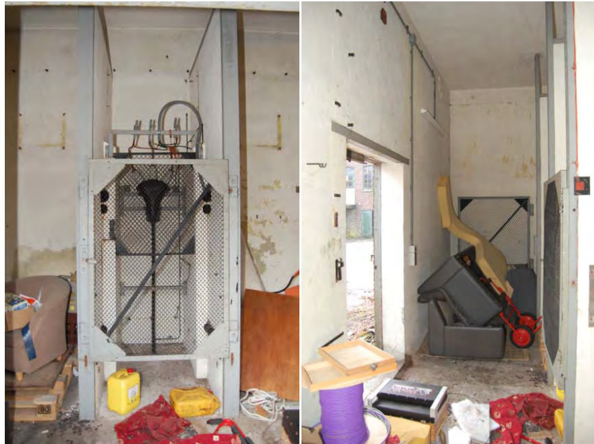
Interieur van het transformatorhuis.
