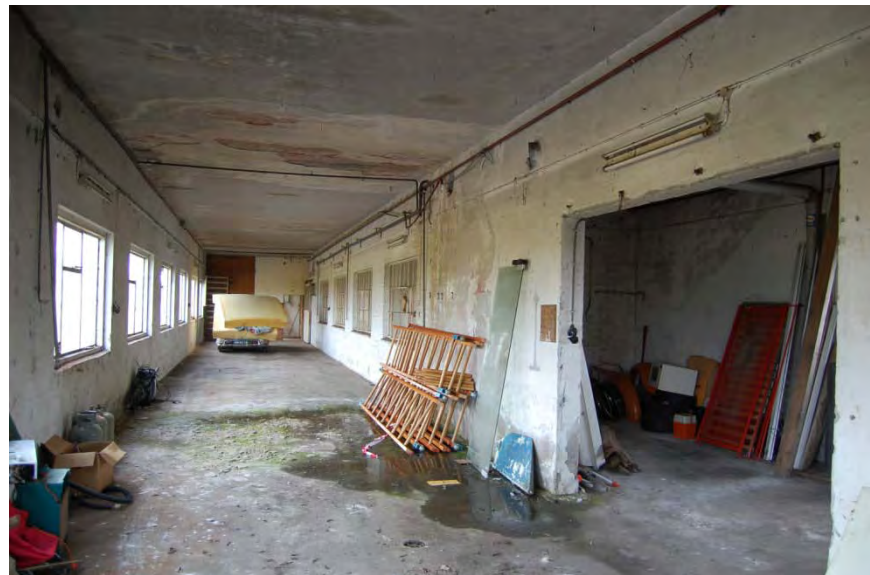
Overzicht van het interieur van gebouw L. Op de achtergrond (achter de auto) een secundaire houten scheidingswand.
