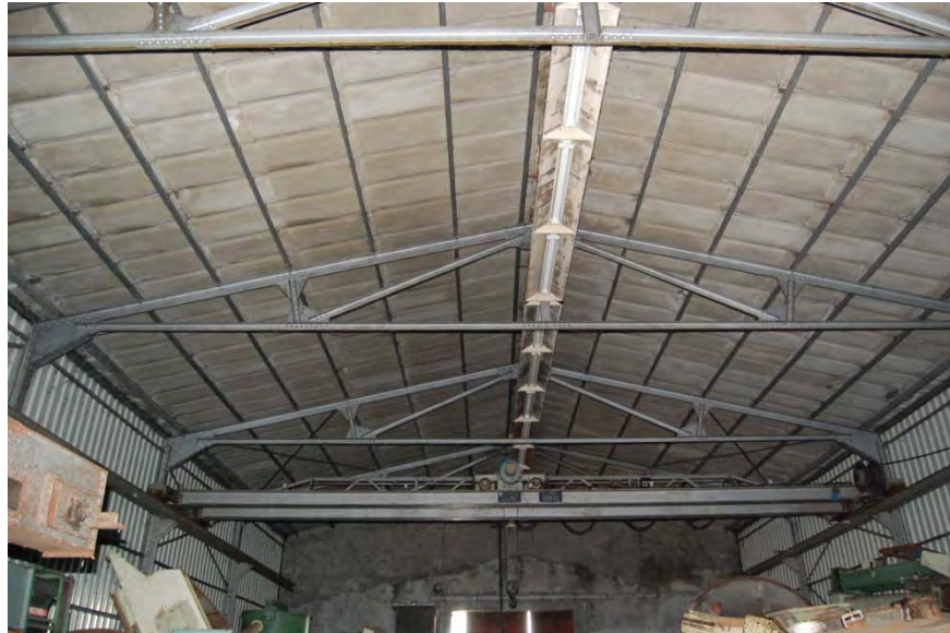
Overzicht van de kapconstructie, gezien naar de voorgevel. Op de achtergrond is ook de loopkraan herkenbaar, opgelegd op de rails aan de wandstijlen van de hoofdconstructie.
