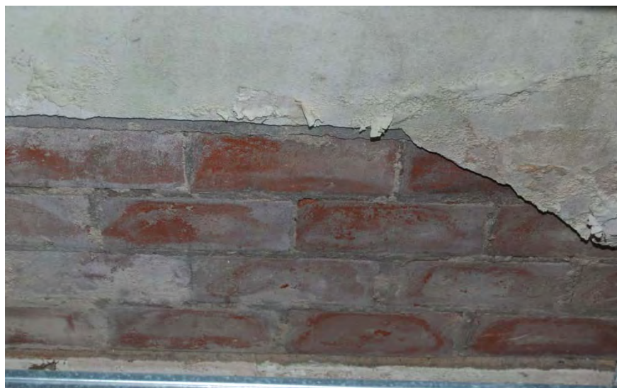
Detail van het baksteendak van de eerste verdieping, bestaande uit gewapende perforavloeren. Delen van het pleisterwerk zijn neergestort.
