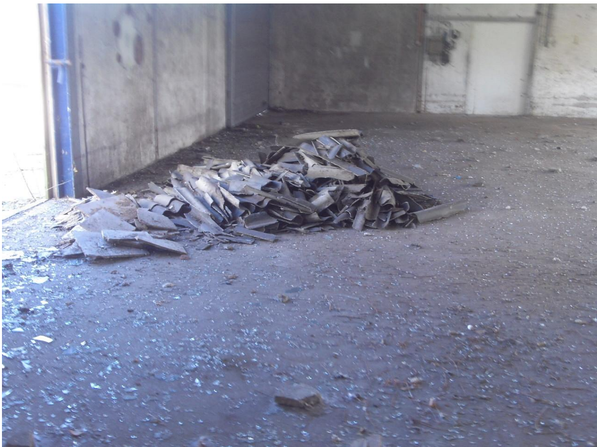
Foto 8: Aangetroffen asbest(verdacht) plaatmateriaal in loods
