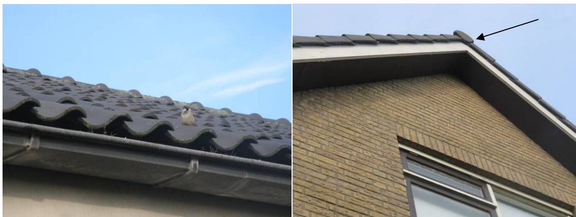
Foto 3 & 4. Aangetroffen huismus op het dak van de garage (links) en de kantpannen en nokpan (rechts) die potentieel een geschikte verblijfplaats vormen voor gebouwbewonende vleermuizen.
