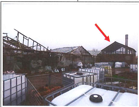
Foto 15: vervallen kassencomplex en oud ketelhuis
