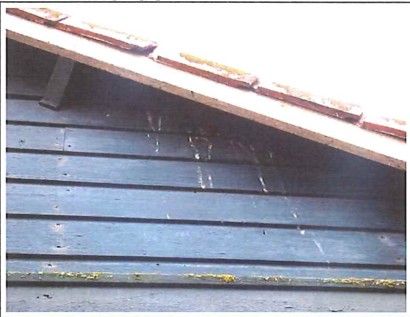
Foto 21: vogelpoepsporen onder dakrand werkschuur
