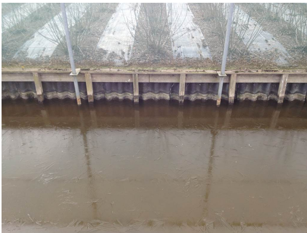
Foto 4 - Asbestverdachte beschoeiing aan de zuidkant van de meest zuidelijk gelegen sloot.
