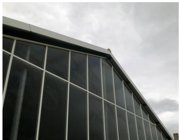
Foto 6: Onder het dakoverstek lijken, ter hoogte van de nok, enkele weggestoken nestplekken van huiszwaluw te zitten (helaas niet goed te zien op de foto)
