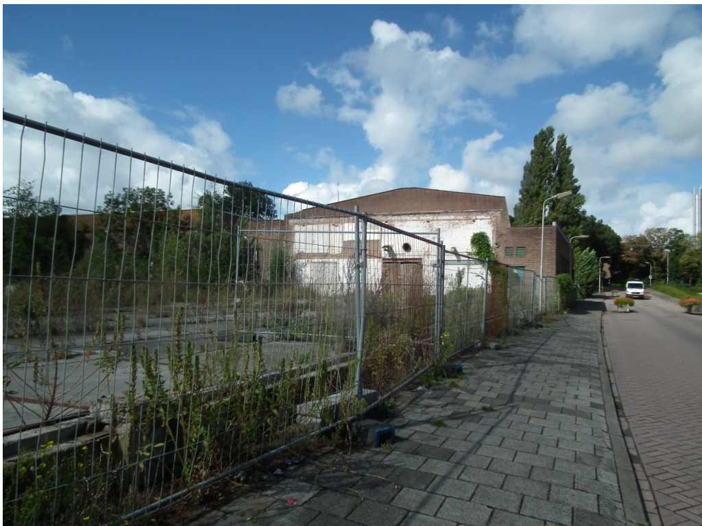
Figuur 2 Aan de oostzijde op de locatie is een deel van de fabrieksofstallen reeds gesloopt. De initiatiefnemer is voornemens de overige opstallen te saneren ten behoeve van woningbouw.
