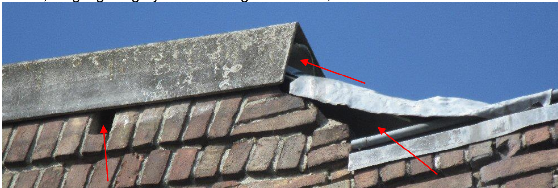
Foto 8, toegangsmogelijkheden dwergvleermuizen, Huismus en Gierzwaluwen
