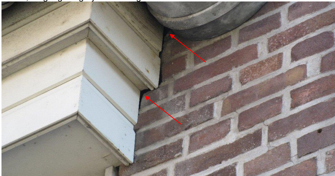
Foto 6, toegangsmogelijkheden dwergvleermuizen, Huismus en Gierzwaluwen
