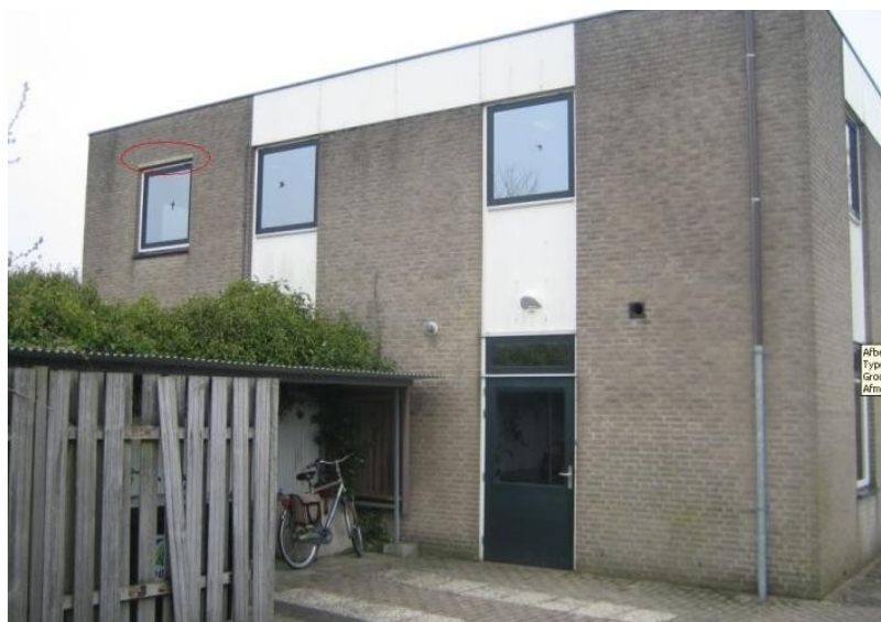
Open stootvoeg in de westgevel kantoorgebouw
