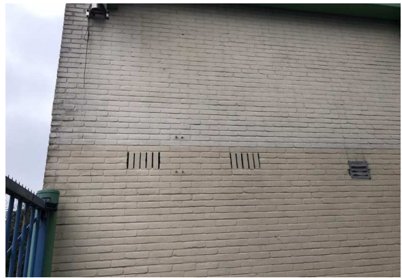
Figuur 6. Open stootvoegen aan de oostgevel van de voormalige stomerij.
