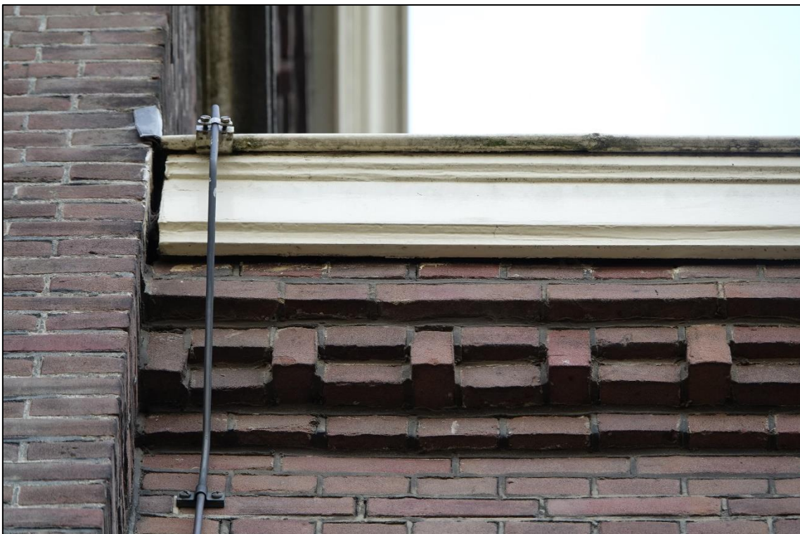
Figuur 11: De bekisting van de dakrand van een deel van de kerk aan de zuidgrens van het plangebied. Te zien is de kier tussen het metselwerk en de houten bekisting van de dakrand.
