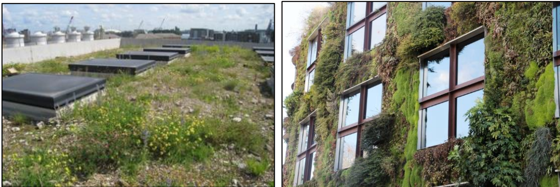
Figuur 6: Bruin dak (links bron: checklist groen bouwen) en groene gevel (rechts bron: groenkennisnet.nl).
