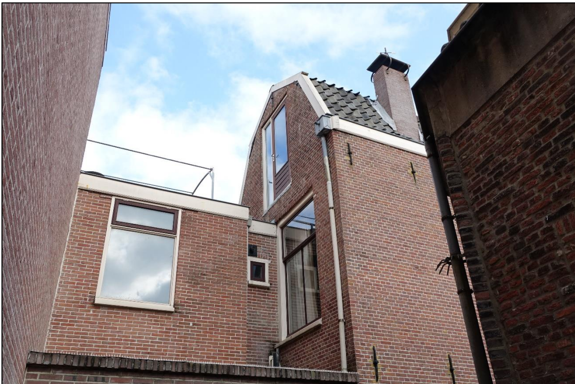
Figuur 12: De woning ten noorden van het plangebied. Dit gebouw heeft toegankelijke dakranden en loszittende dakpannen. Rechts in beeld is de noordwesthoek van de muur van het plangebied te zien.
