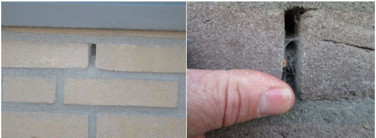
Afbeelding 11a en 11b: Open stootvoeg vol met cementresten nabij daklijst. Te smalle open stootvoeg met cement en spinrag.
