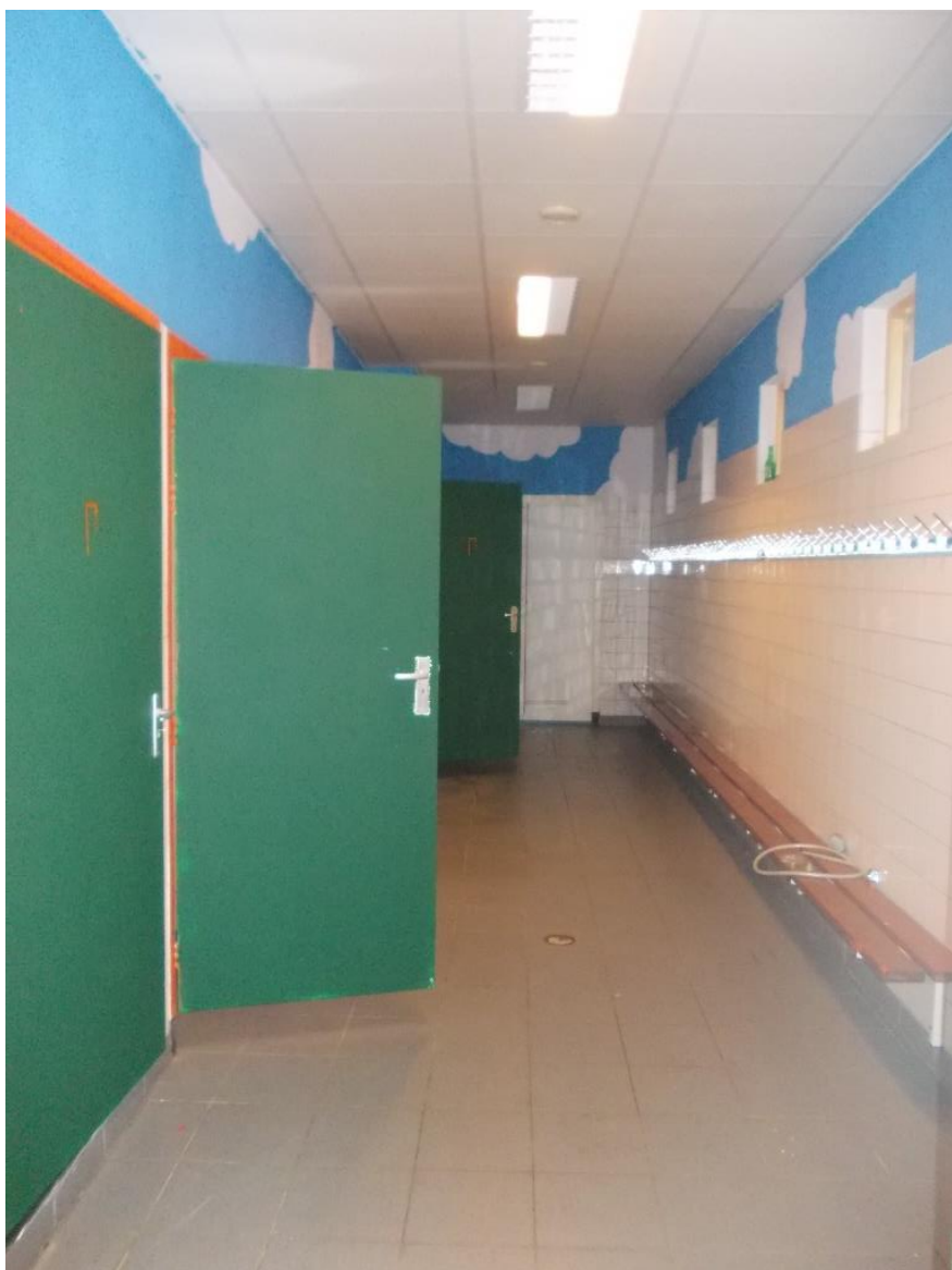
Was- en kleedruimte
