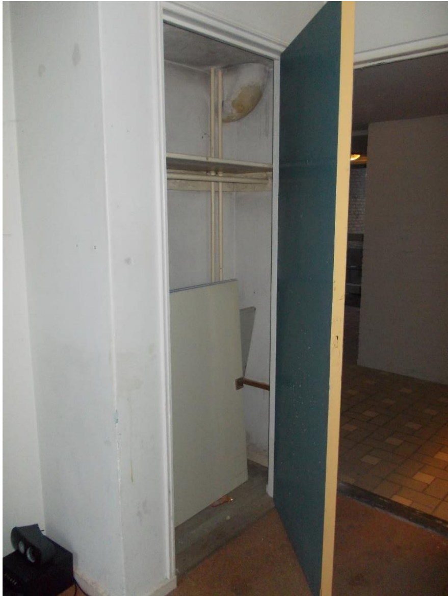
Belendende ruimte met inbouwkast
