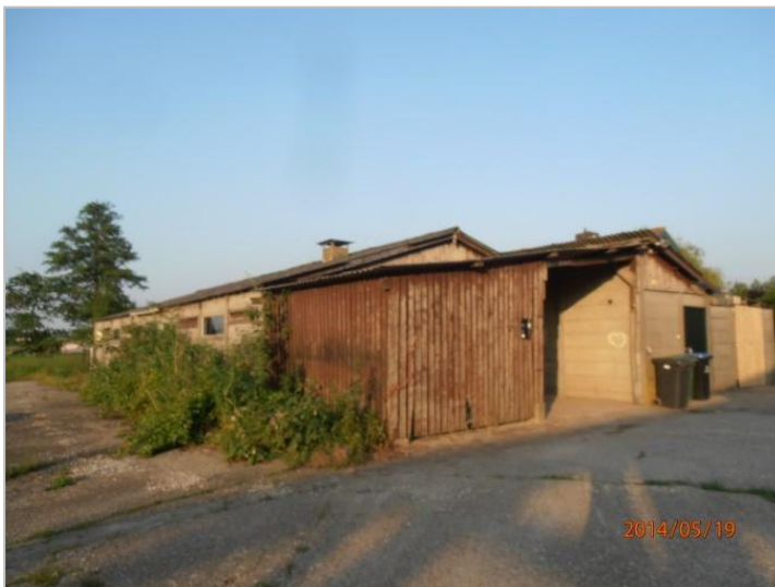
Schuur 2 (voormalige kippenschuur) Betreft een open voormalige kippenschuur. Invliegmogelijkheden voor vleermuizen zijn aangetroffen bij schuurdeuren, openstaande ventilatieroosters, gebroken ramen, tussen dakbedekking (golfplaten) en muur, door schoorsteen / ventilatiekanaal. Op de betonvloer van de schuur zijn (oude) vleermuiskeutels aangetroffen.
