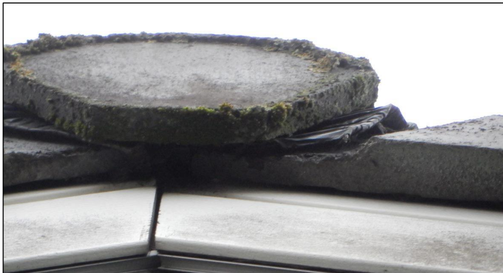
Figuur 6 De nokpan aan de zuidoostzijde van het dubbele woonhuis sluit strak op de kantpannen aan.
