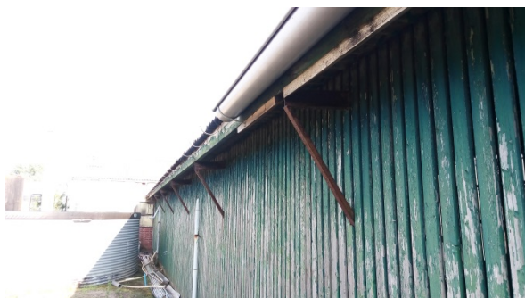
Foto 3: Aanwezige/ ontbrekende dakgoot.
