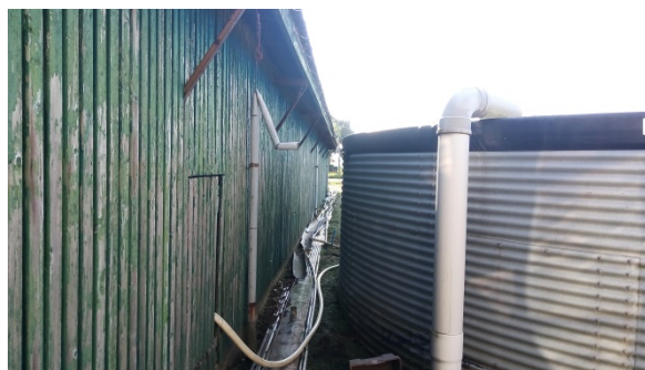
Foto 4: Ontbrekende dakgoot westelijk deel.
