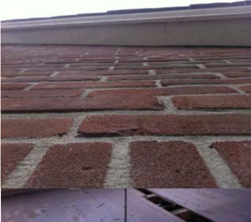
Overstek en muur woon/werkgebouw. Veel spinnenrag onder overstek.
