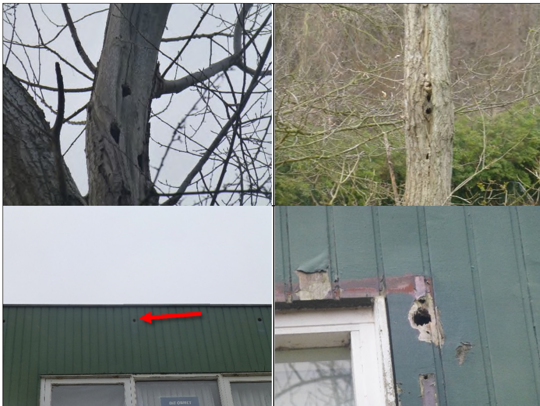
Figuur 5.3. Impressie mogelijkheden voor vleermuizen om achter weg te kruipen en/of mogelijkheden die toegang bieden tot geschikte verblijfplaatsen.
