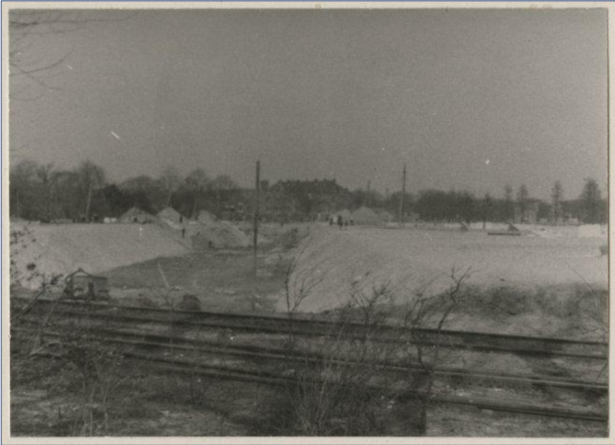
Figuur 4: Foto van de tankgracht in wording ter hoogte van de Verhulststraat,, genomen vanaf de Kranenburgweg. 17
