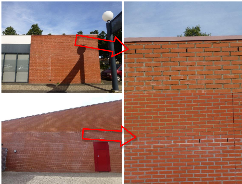
Figuur 5.2. Spouwmuurgaten die vleermuizen toegang kunnen geven tot de spouwmuuren. Spouwmuuren vormen potentiële (beschermde) vaste rust- en verblijfplaatsen.
