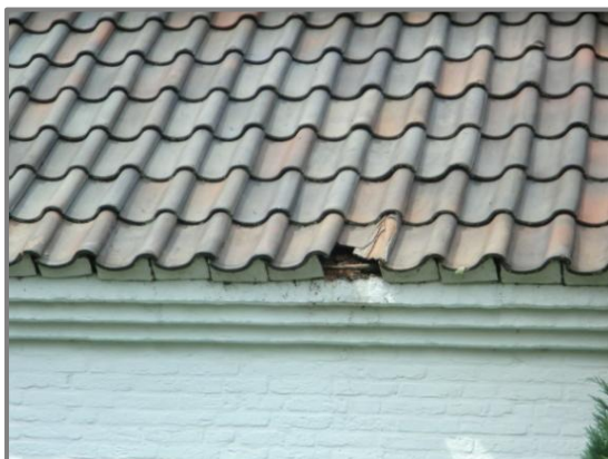
Afbeelding 1: Beschadigd dak westelijk woning.
