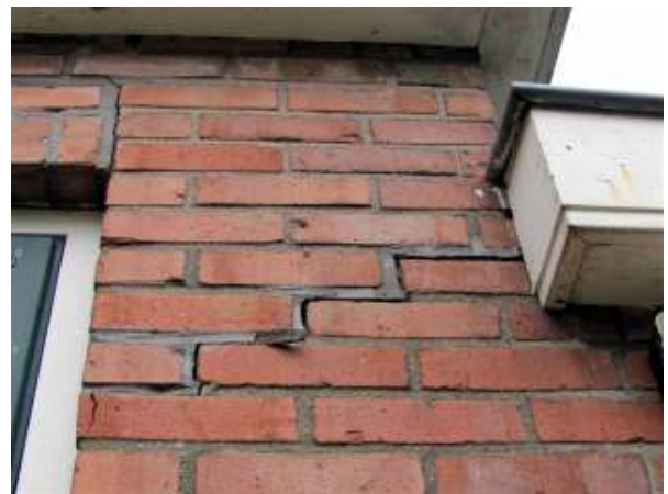
Figuur 13: Smalle, dichtgekitte scheur in muur
