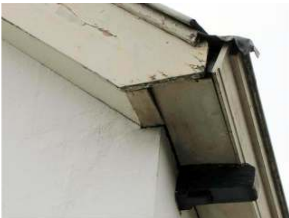
Figuur 12: Dakgoot aan rechter voorzijde.
