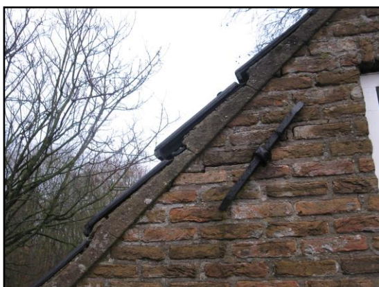
Foto 5: Openingen tussen dakpannen
