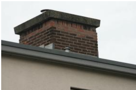
Foto 7: open stootvoegen in schoorstenen, potentiële toegangen tot verblijfplaatsen van vleermuizen
