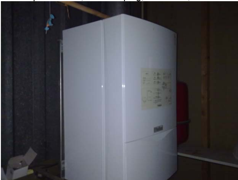
Foto 4: pand nr. 96, 1 e verdieping, Cv-ruimte, nieuwe Cv-ketels
