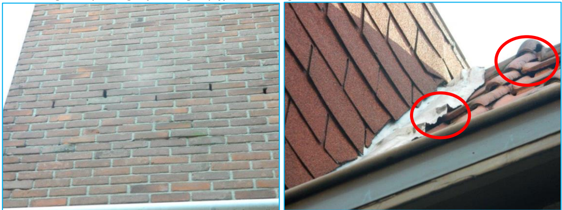
Foto's: Openingen bij de opstal die toegang kunnen bieden naar mogelijke vaste verblijfplaatsen van vleermuizen.
