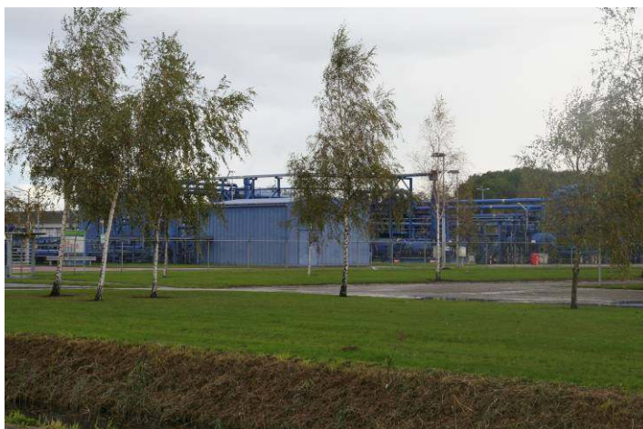
Figuur 21. Deel van het gasreducerstation .
