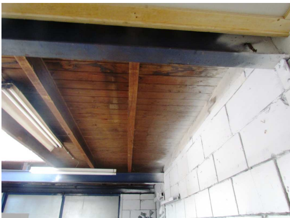
Dak- en muurconstructie fabriekshal W Kloosstr 62: niet geschikt voor vleermuizen
