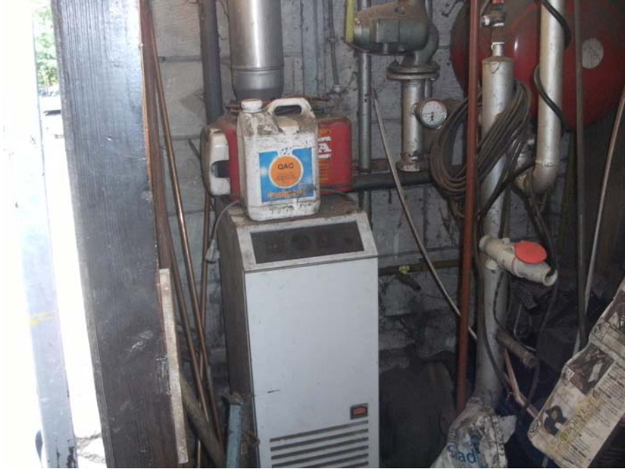
Foto 1: Cv-ketel van het merk Radson uit 1989 in de loods + rubberen pakkingen in de loods
