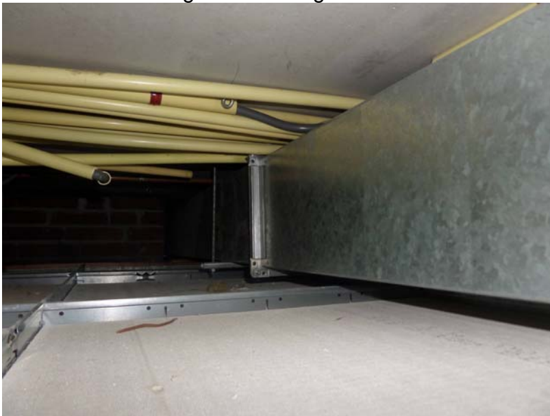
Foto 12: ontluchting is vervaardigd van staal
