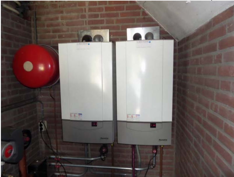
Foto 14: 2 stuks nieuwe Cv-ketels in de Cv-ruimte (Remeha Quinta uit 2006)
