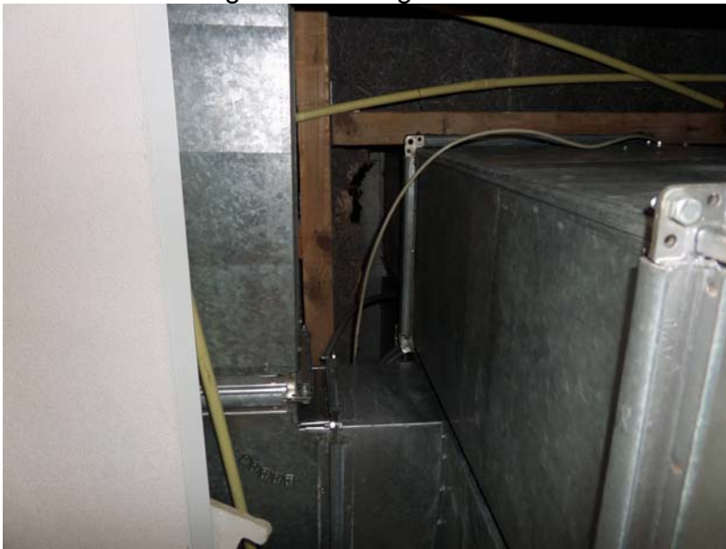
Foto 6: ontluchting is vervaardigd van staal
