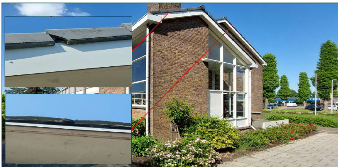
Figuur 3.3 Kierende kantpannen en openingen in tussen de dakpannen geven gierzwaluwen toegang tot geschikte nestlocaties.
