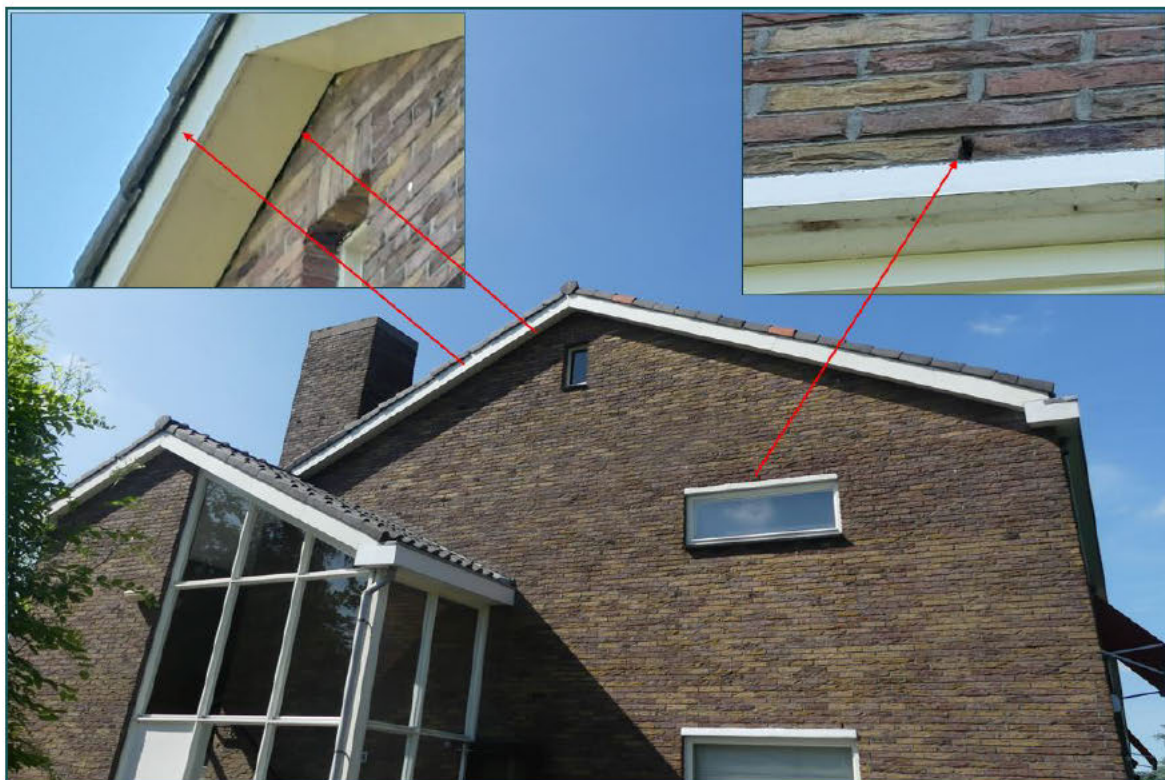
Figuur 3.1 In het appartementencomplex zijn open stootvoegen aanwezig. Tussen de muren en de overstek zijn kieren aanwezig. Er zijn kierende kantpannen aanwezig waardoor vleermuizen toegang hebben tot geschikte ruimtes.
