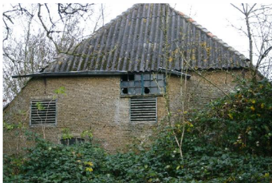
Figuur 4.4.1. Meerdere ramen in de voormalige boerderijwoning zijn stuk.
