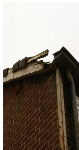
Foto 42: Ontbreken van dakpannen
