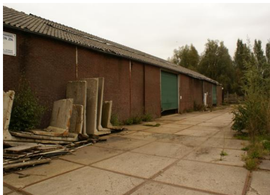
Foto 40: Het vervallen gebouw (locatie 9)
