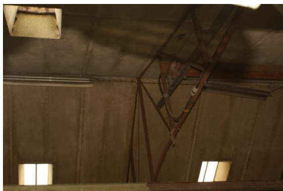
Foto 43: Binnenin het vervallen gebouw (locatie 9)
