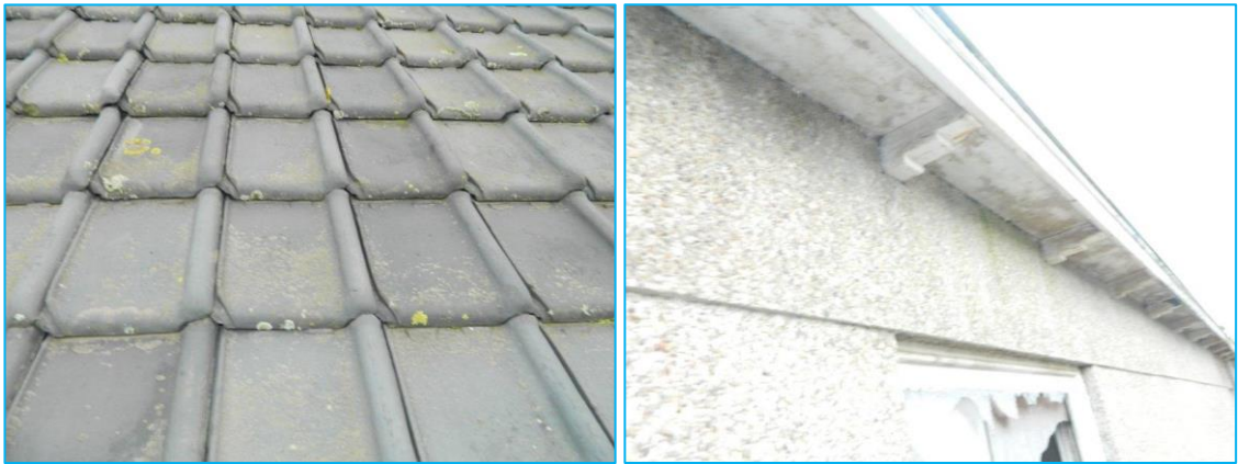
Foto's: Ontbreken openingen bij opstallen.
