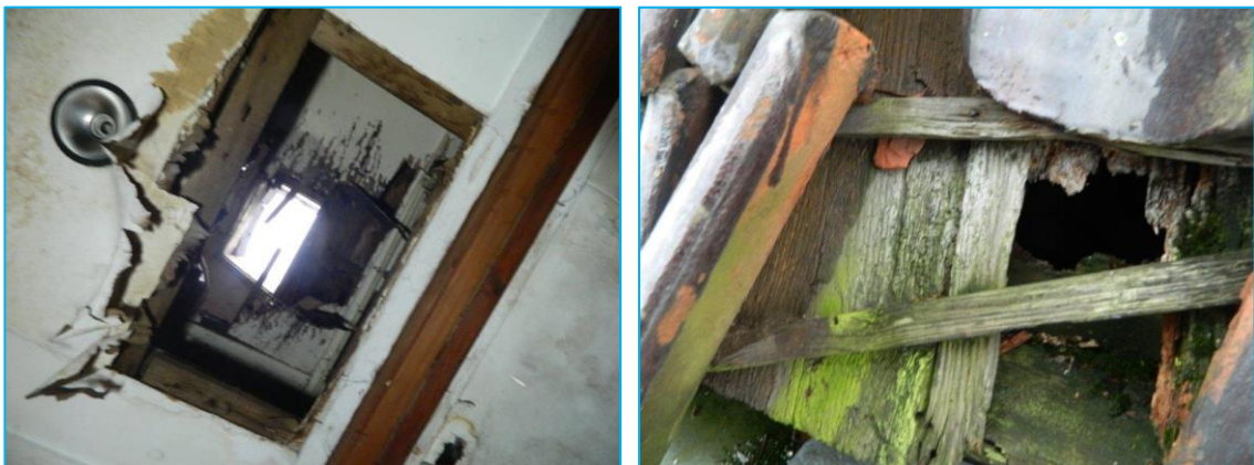
Foto's: Slechte staat van onderhoud opstallen.
