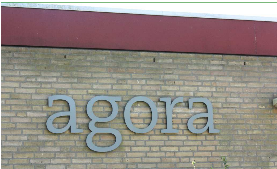
Open stoetvoegen aan meerdere zijden van het schoolgebouw.
