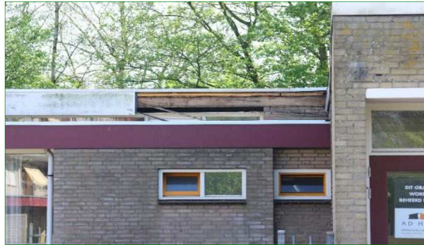
Afwezigheid van gevelbekleding geeft toegang tot ruimte onder het dak..
