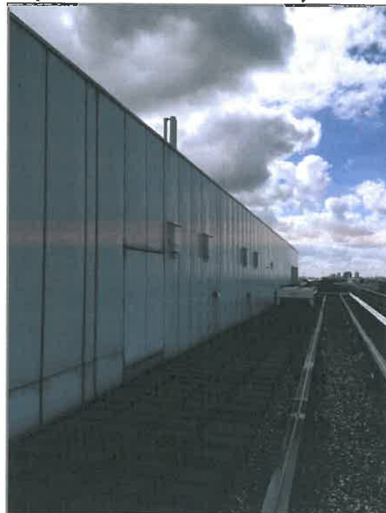
Geplaatste kasten noordoostzijde
