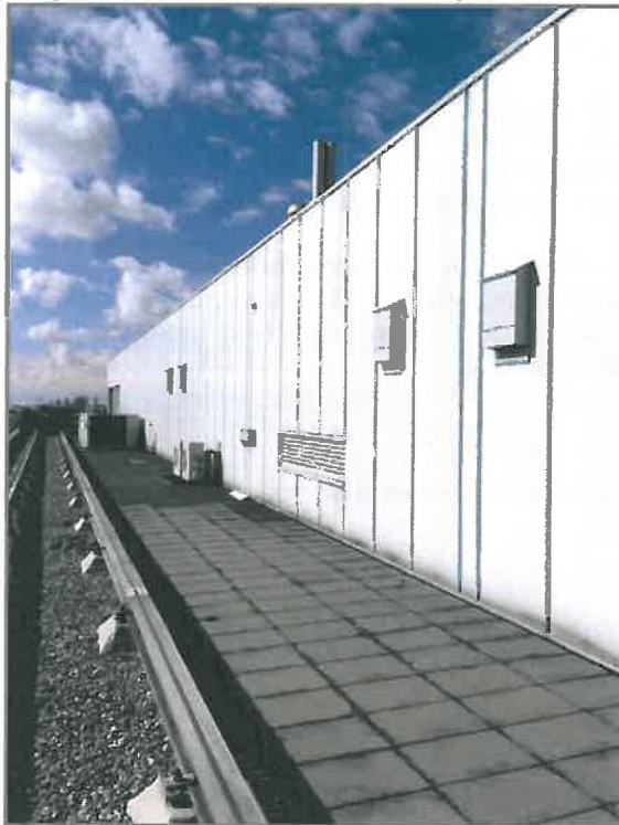
Geplaatste kasten zuidwestzijde
