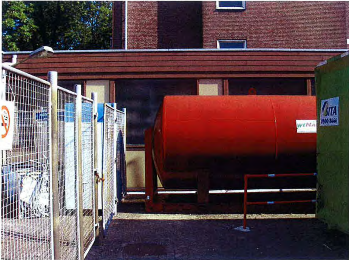
Foto 1 Bovengrondse tank nabij ketelhuis
