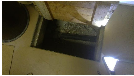
Foto voor Bron 4 Rioleringsbuis
