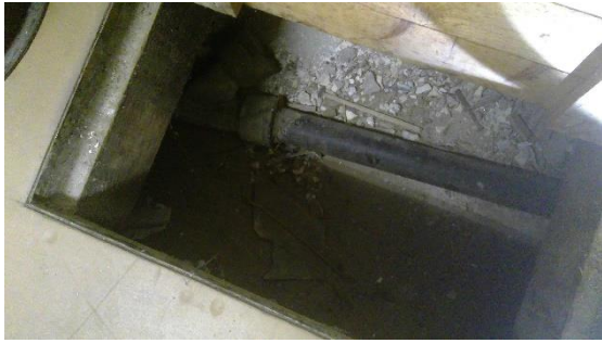
Foto voor Bron 4 Rioleringsbuis
